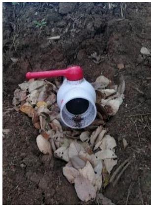
Efluente laguna módulo A
