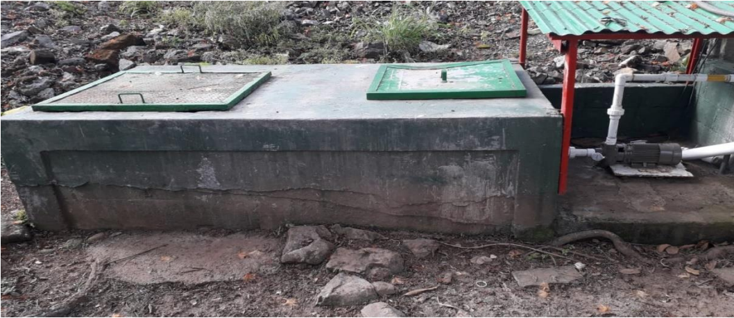
Figura 7. Cárcamo de bombeo
