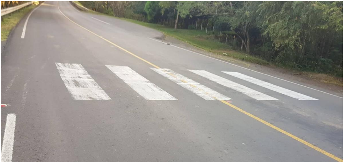
Imagen 41: Falta de mejoramiento de pintura en paso peatonal – km 149 Comarca Santa Rita
