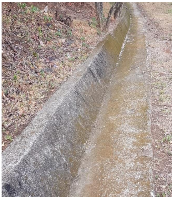
Imagen 10: Salida Juigalpa – Apompuá Estación 143 + 500, drenaje menor de concreto tipo triangular
