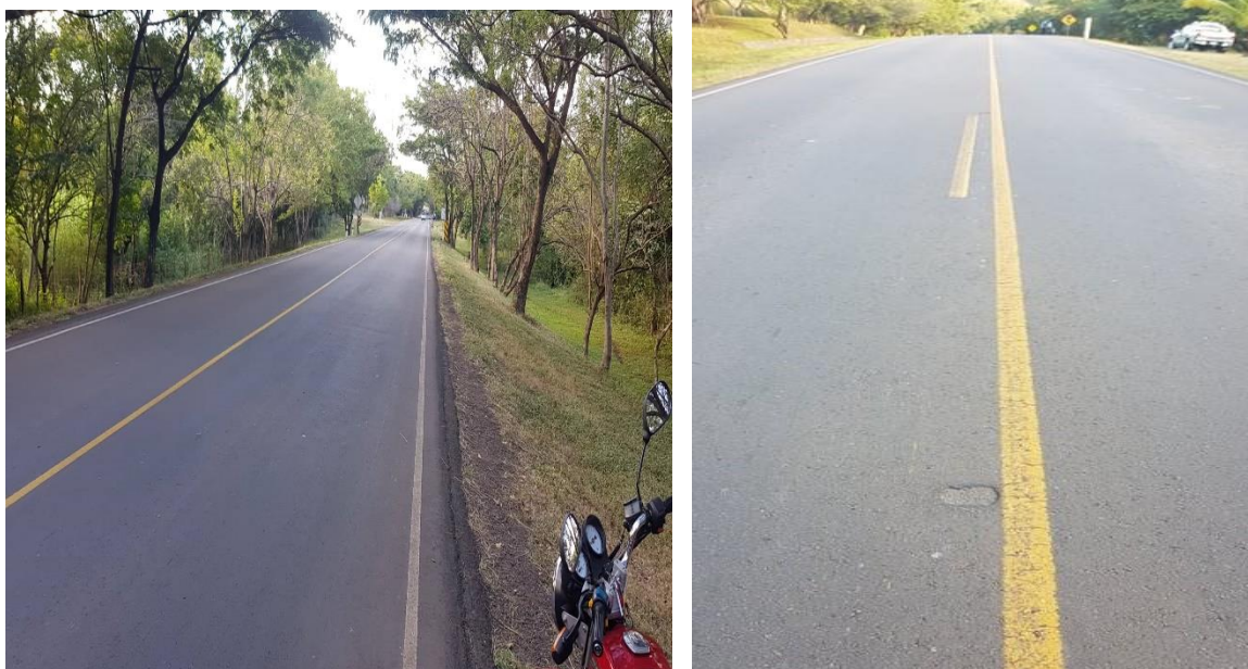
Imagen 43: Falta de presencia de tachas reflectivas u ojos de gatos – km 147 al km 149
