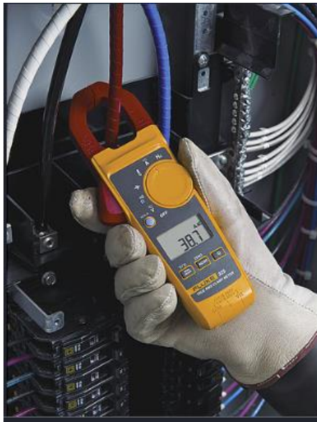
Figura 5, (Medición de parámetros eléctricos)
