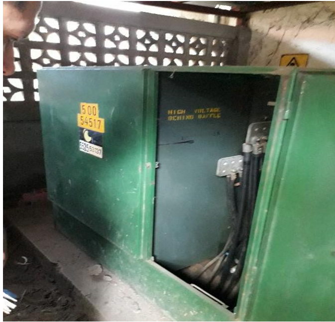
Figura 10: Banco de transformador de 500 kVA
