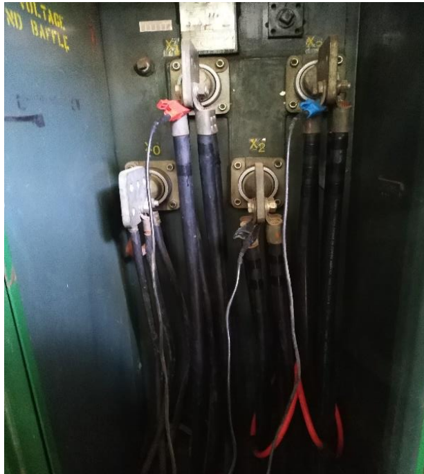
Figura11: Medición del Banco de Transformador 500 kVA
