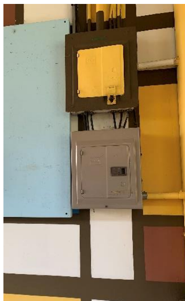
Figura 41. "Panel sin señalización ubicado en primer piso FARQ". Fuente: Elaboración Propia.
