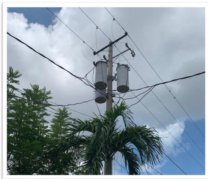
Figura 5. “Banco de Transformadores BT 13”. Fuente: Elaboración Propia.
