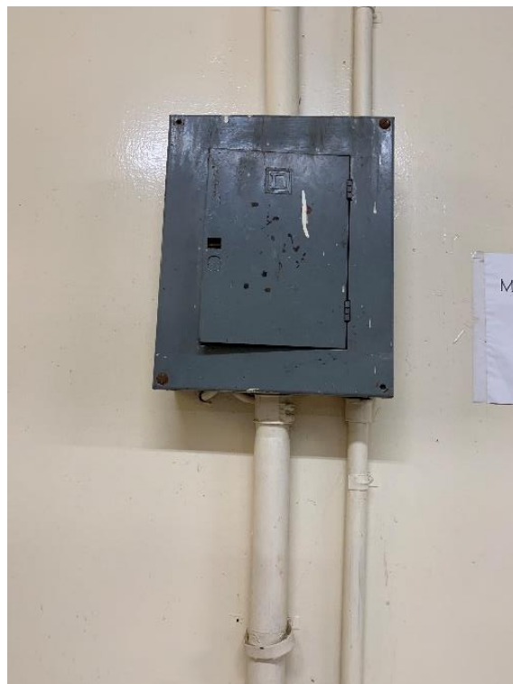
Figura 43. "Panel sin señalización ubicado en Lab. Automatización". Fuente: Elaboración Propia.
