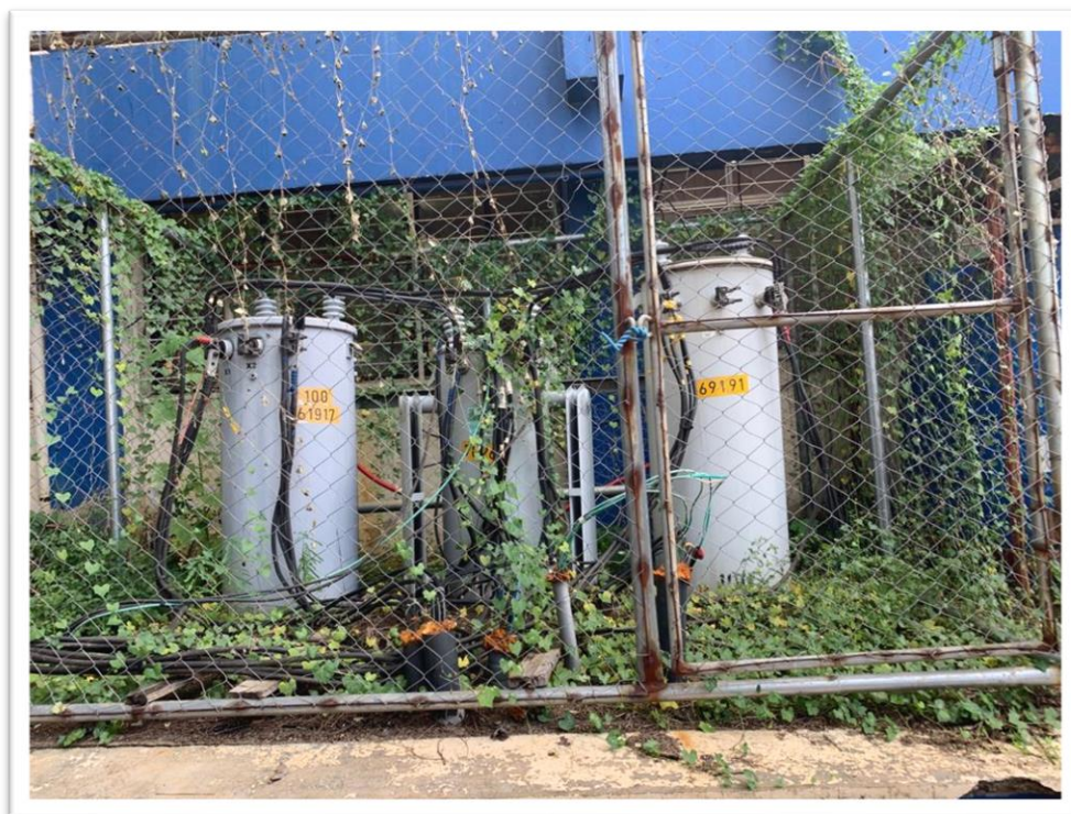
Figura 7. “Banco de Transformadores BT 15”. Fuente: Elaboración Propia.
