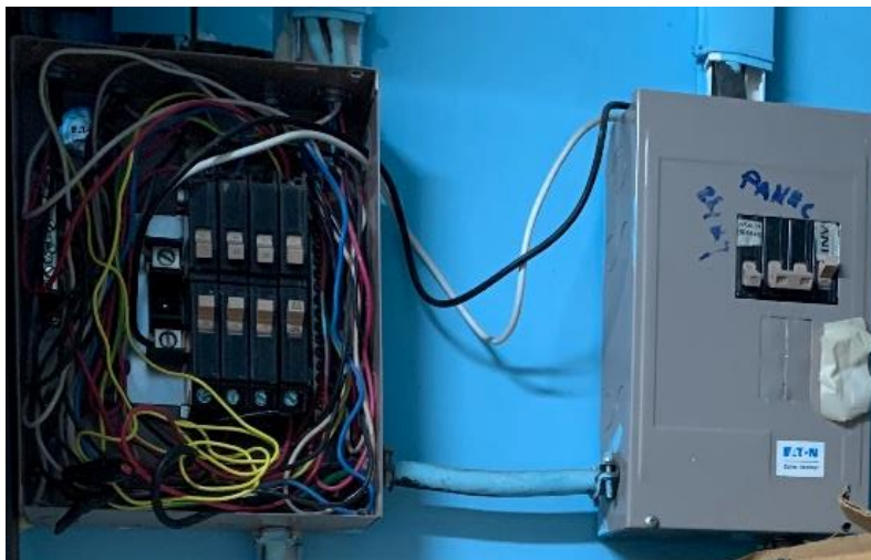
Figura 55. "Conductores en panel PA4.1.1" ubicado en segundo piso comp. Fuente: Elaboración Propia.
