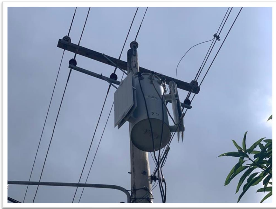
Figura 4. “Transformador BT 11”. Fuente: Elaboración Propia.
