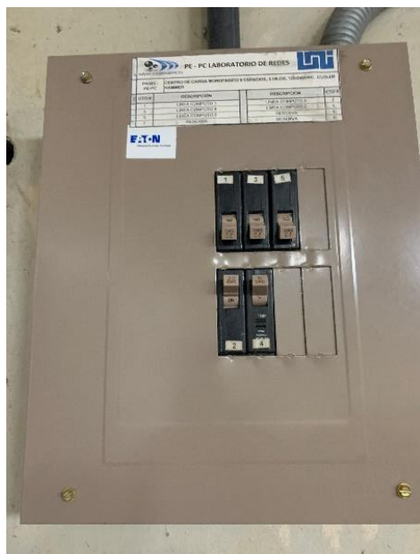
Figura 42. "Panel sin señalización ubicado en Lab. Redes de Compt.". Fuente: Elaboración Propia.
