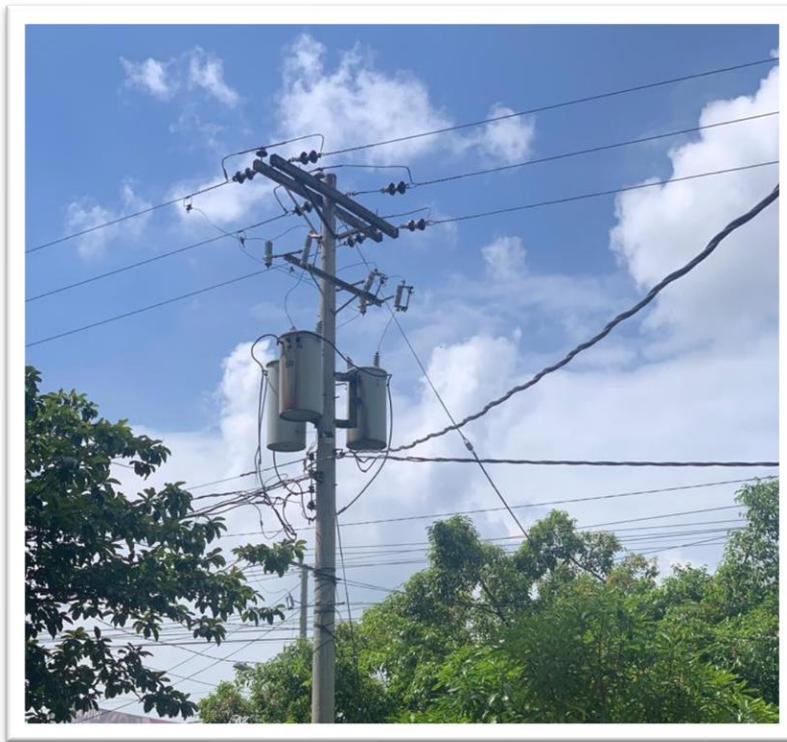
Figura 6. “Banco de Transformadores BT 14”. Fuente: Elaboración Propia.
