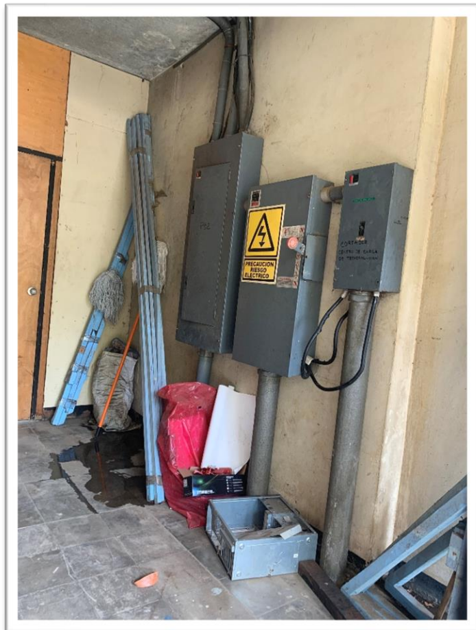
Figura 22. “Ubicación de PB 2 en cuarto de paneles”. Fuente: Elaboración Propia.
