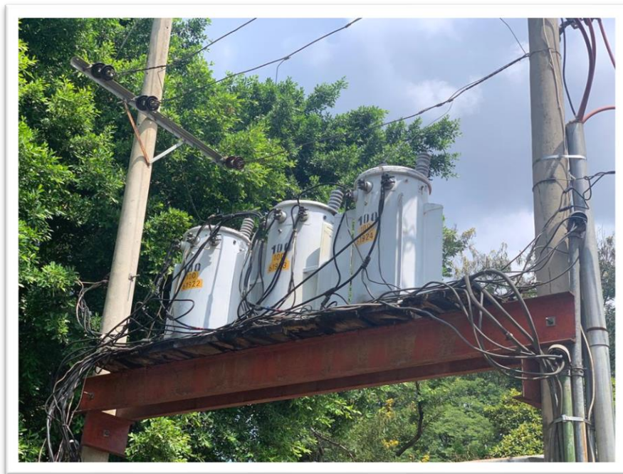
Figura 9. “Banco de Transformadores BT 17”. Fuente: Elaboración Propia.
