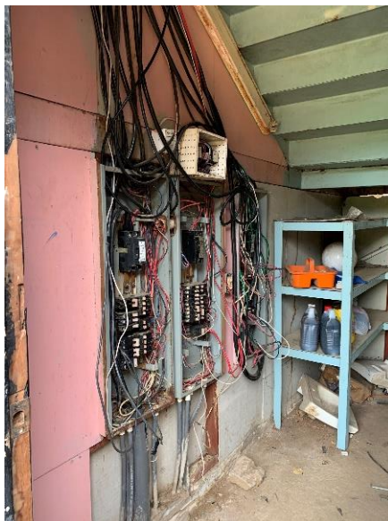
Figura 45. "Cuarto sin señalización ubicado en pabellón 11". Fuente: Elaboración Propia.
