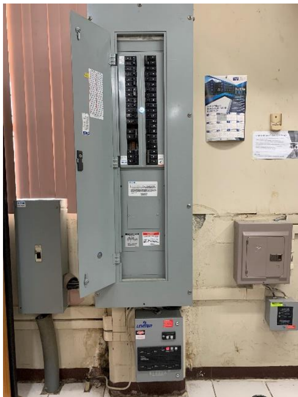
Figura 44. "Panel sin señalización ubicado en Lab. Procesos". Fuente: Elaboración Propia.
