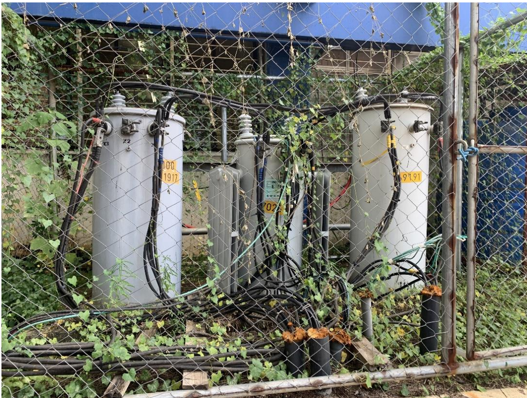
Figura 30. "Banco de Transformadores 15". Fuente: Elaboración Propia.
