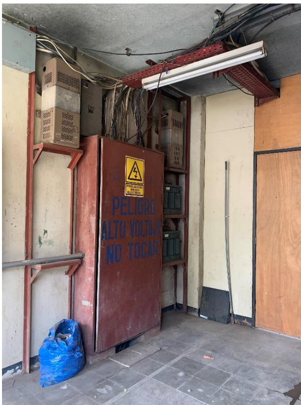
Figura 18. “Parte externa gabinete PB1”. Fuente: Elaboración Propia.
