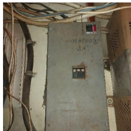
Figura 47. "Señalización inadecuada/desactualizada de dispositivo". Fuente: Elaboración Propia.
