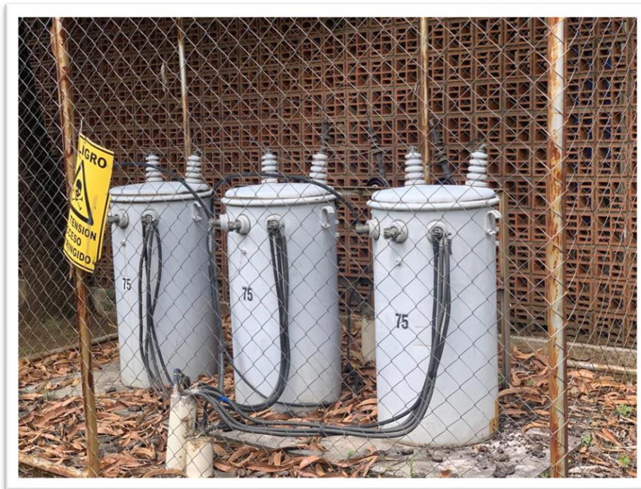
Figura 8. “Banco de Transformadores BT 16”. Fuente: Elaboración Propia.
