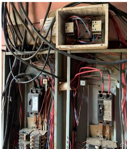
Figura 50. "Estado de paneles en pabellón 11". Fuente: Elaboración Propia.
