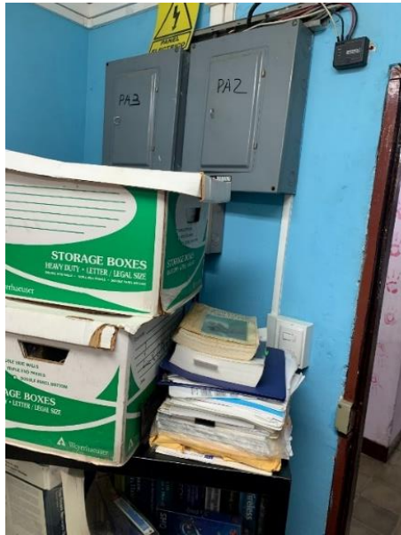
Figura 53. "Ubicación obstaculizada de panel PA2" ubicado en segundo piso comp. Fuente: Elaboración Propia.
