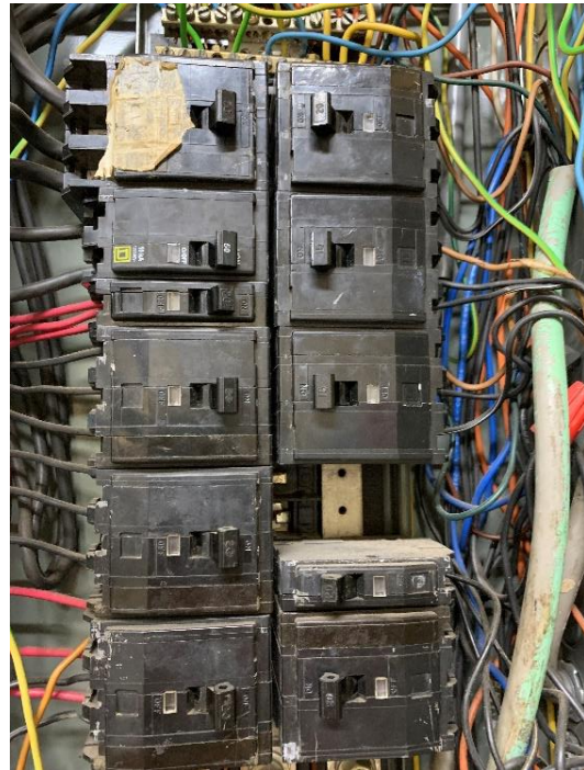
Figura 14. “Panel M1” ubicado en Lab. Máquinas Eléctricas. Fuente: Elaboración Propia.
