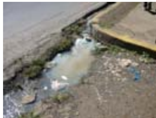
Fotografía 17. Calles afectadas por la falta de Alcantarillado sanitario. Fuente: Autora 2010
