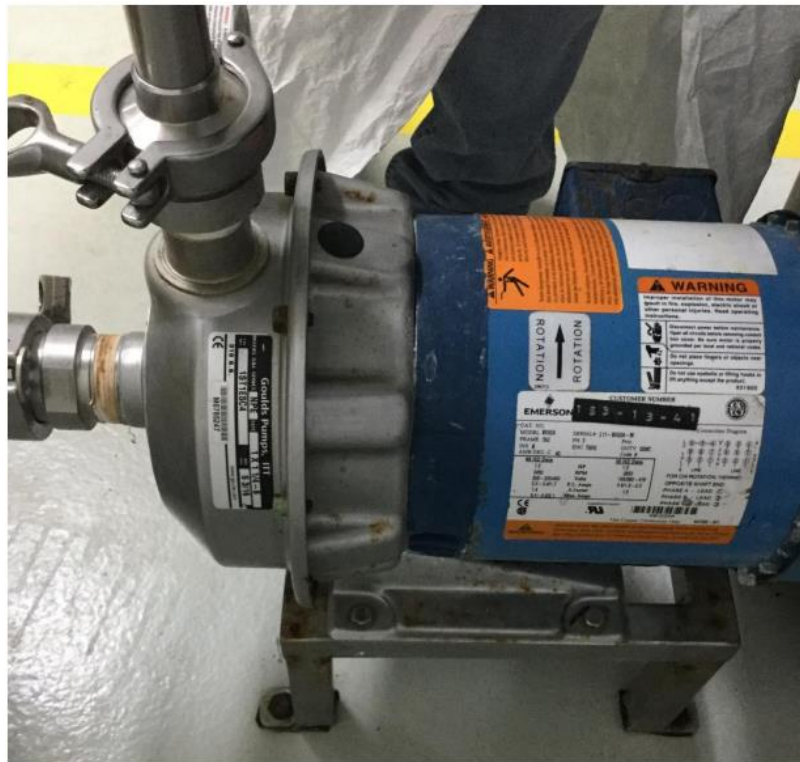
Figura 57: Bomba post filtro de arena
