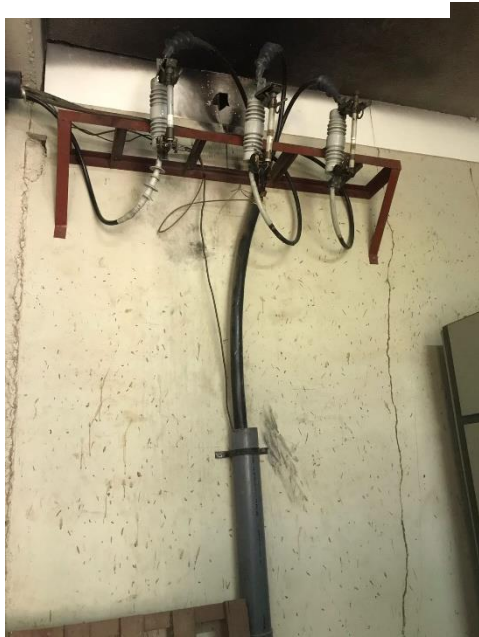
Ilustración 11 cuchillas de transferencia del transformador I
