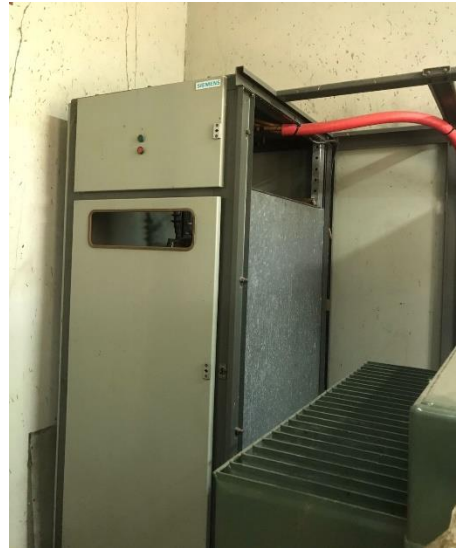
Ilustración 12 sistema de media tensión en transformador I
