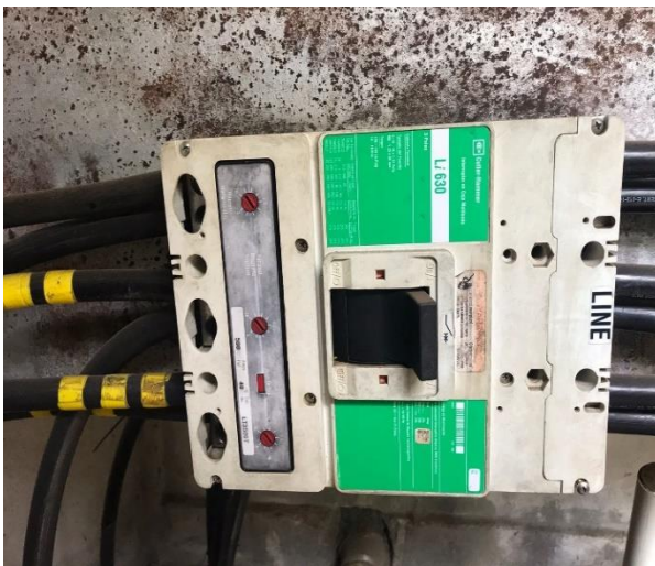
Ilustración 26 interruptor principal de CIDEA, colocado sobre un perlin sin tapa
