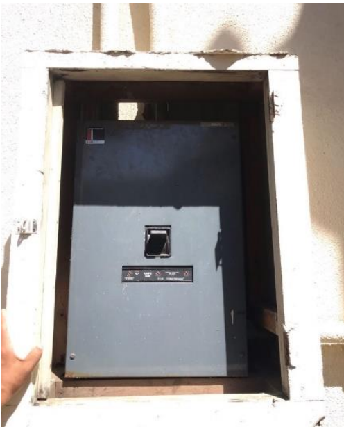
Ilustración 3 breaker principal de rectoría se encuentra a la intemperie
