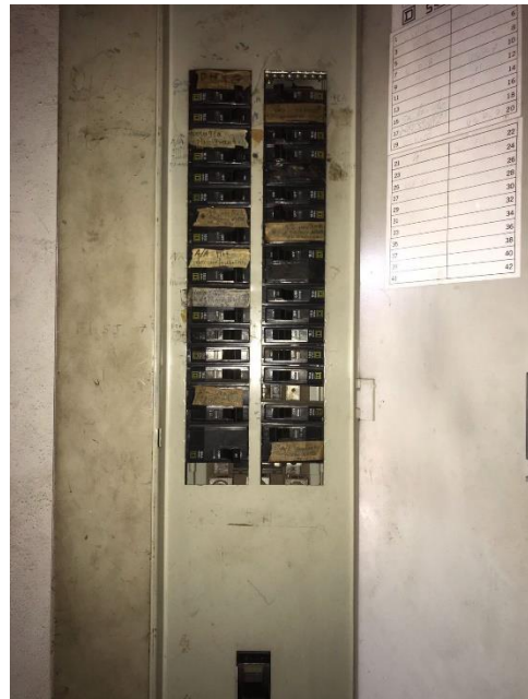
Ilustración 16 panel secundario edificio I
