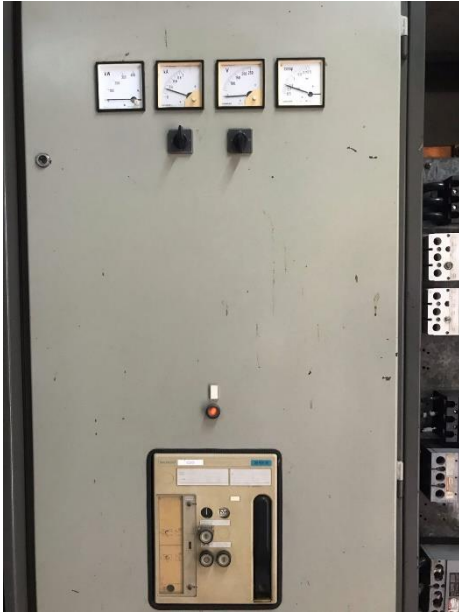
Ilustración 13 CELDA DEL TRANSFORMADOR I
