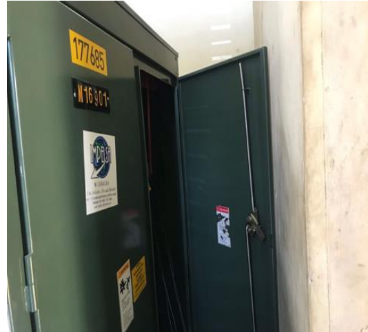
Ilustración 2 Transformador de rectoría, frente al mismo se encuentra una pared
