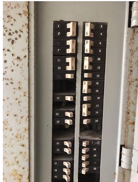
Ilustración 8 PRL del edificio E, con oxidación y heces de roedores
