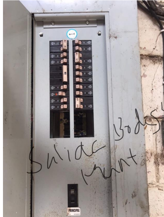
Ilustración 22 panel eléctrico de mantenimiento, ubicado a la intemperie
