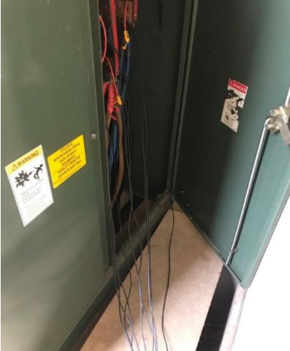
Ilustración 1 Transformador de Rectoría, se aprecia que la puerta del mismo no abre a su totalidad
