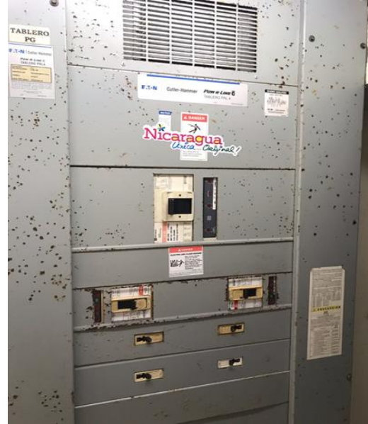
Ilustración 6 panel principal edificio E, muestra oxidación y heces de roedores
