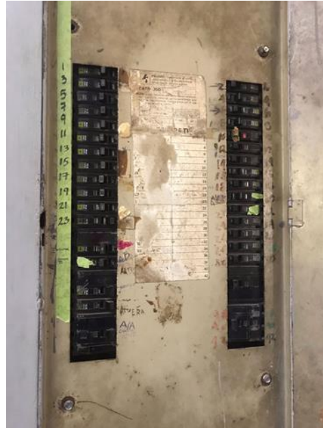
Ilustración 10 panel aula magna, oxidado y obsoleto
