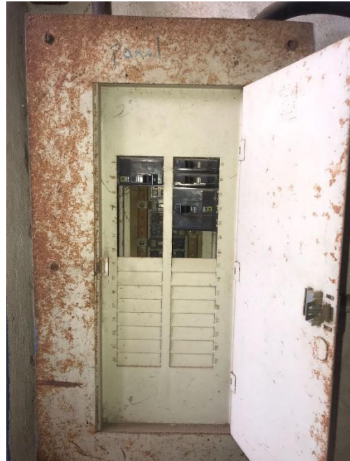
Ilustración 18 panel eléctrico edificio I, muy oxidado
