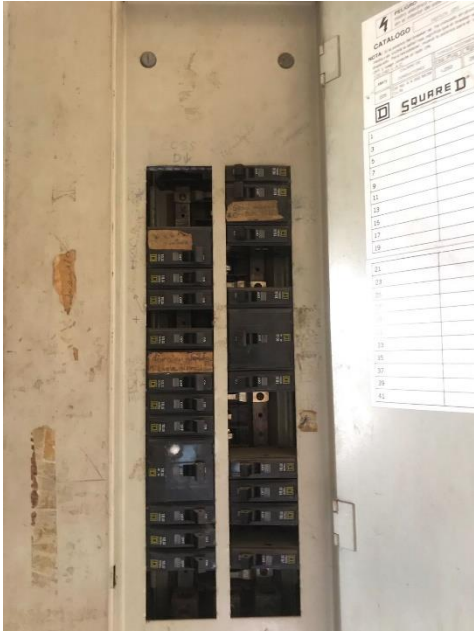
Ilustración17 panel eléctrico edificio I, antiguo y sin leyenda
