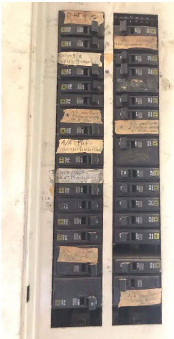
Ilustración 14 panel secundario edificio I
