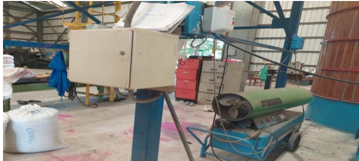
Figura 19. Panel de control del motor y el ventilador de la secadora.
