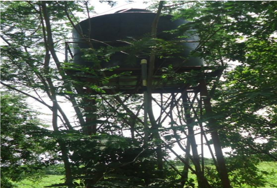
Foto N° 14: Torre metálica/ Tanque 2,500 glns.
