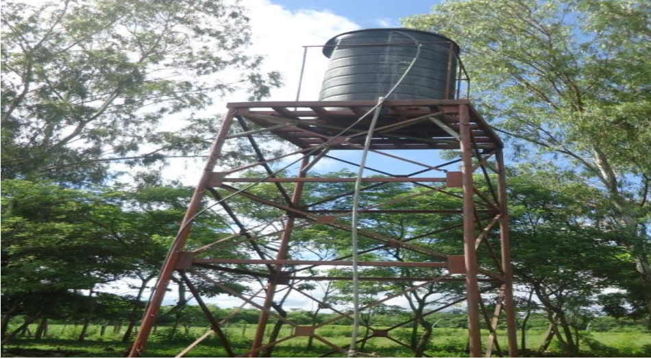
Foto N° 13: Torre Metálica/ tanque 2,000 glns.
