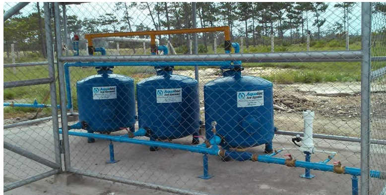
Figura No 6 Filtros presurizados rurales
