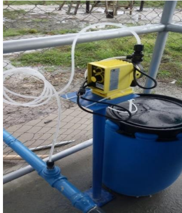
Figura No 8 Bomba dosificadora de cloro
