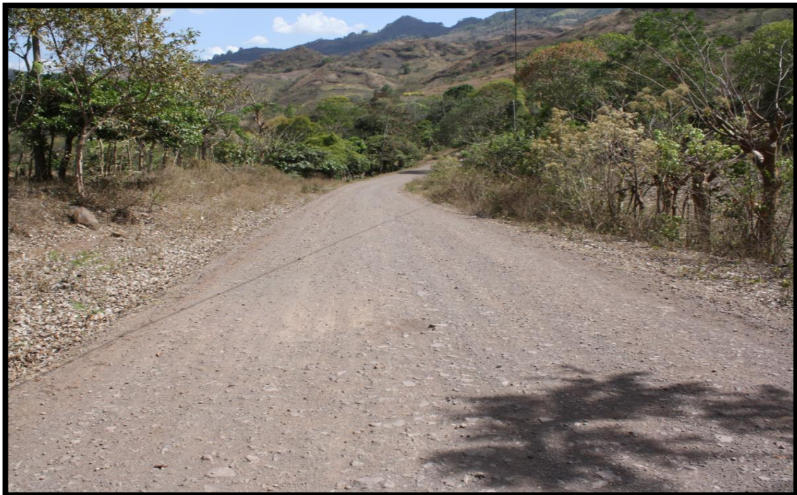
Foto 2: Estación 0+230, Inexistencia de Obras de Drenaje.
