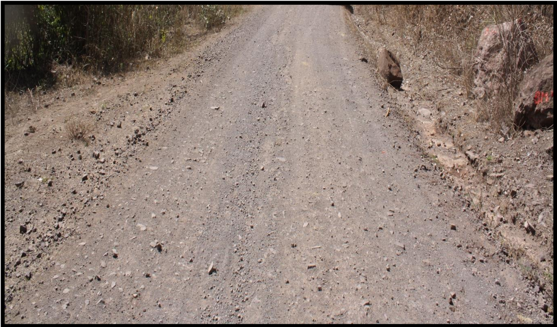
Foto 5: Estación 0+930, Erosión y Desgaste de la Carpeta de Rodamiento.
