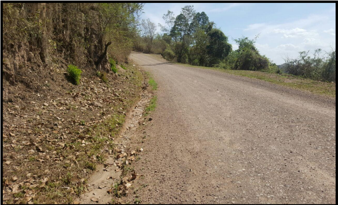
Foto 3: Estación 0+400, Erosión del revestimiento en la vía.
