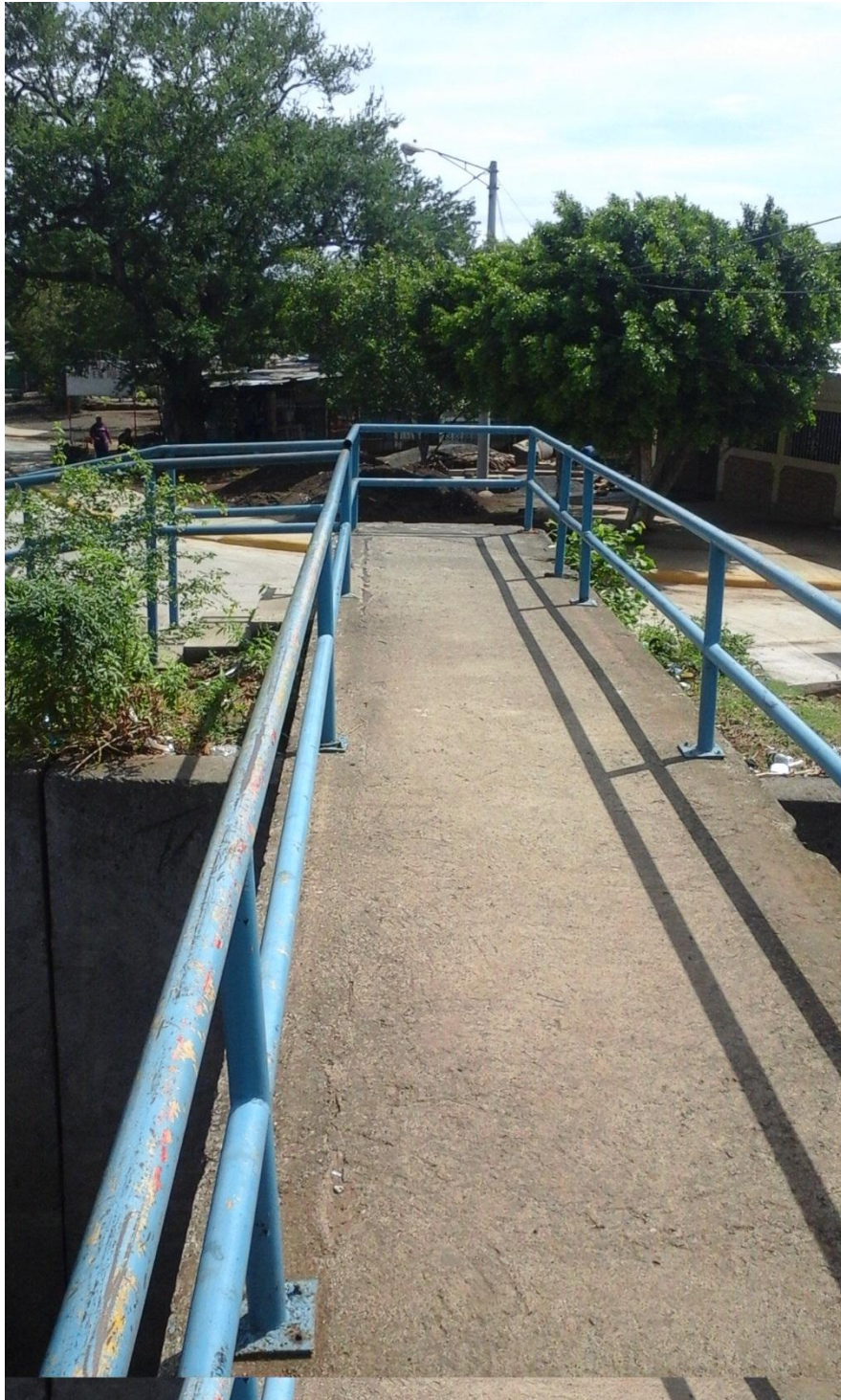
Foto 4 Desnivel de la calle al este del cauce
