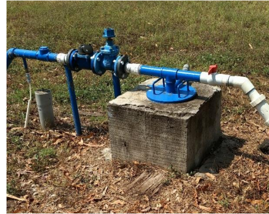
Foto 2. Equipo de Bombeo Pozo DENISA-El Cortijo
