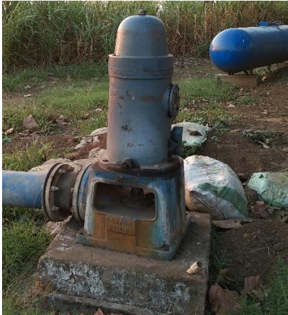
Foto 1. Equipo de Bombeo Pozo Los Silvas
