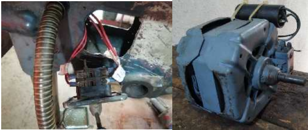
Fig. N°23. instalación eléctrica y motor eléctrico.
