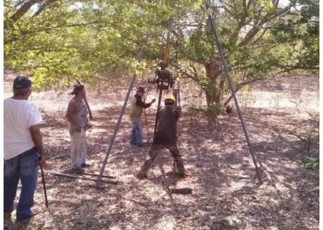
Imagen 09: Perforación en el Área prevista para la instalación del tanque de almacenamiento.
