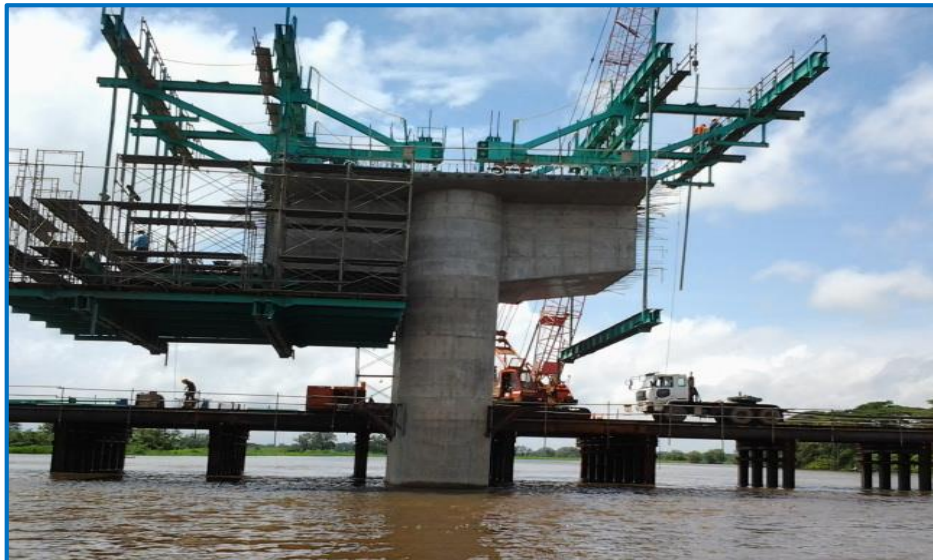
Figura 2. Utilización del carro de avance en la construcción del puente Santa Fe
