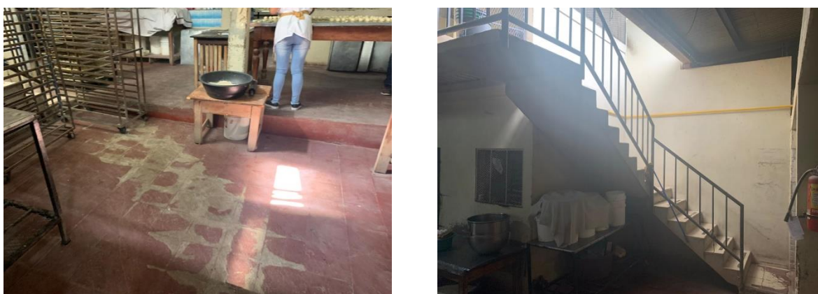
Ilustración 1. Piso desgastado y escalones en panadería Lanuza
