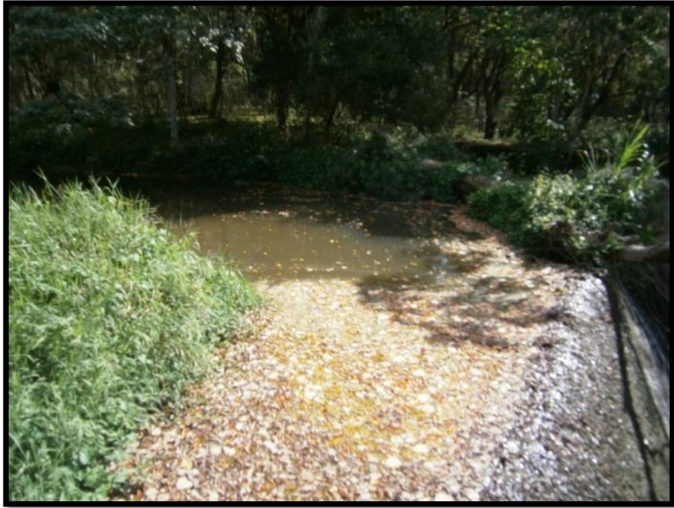
Fotografía Núm. 5 Presa San Francisco Azolvada
