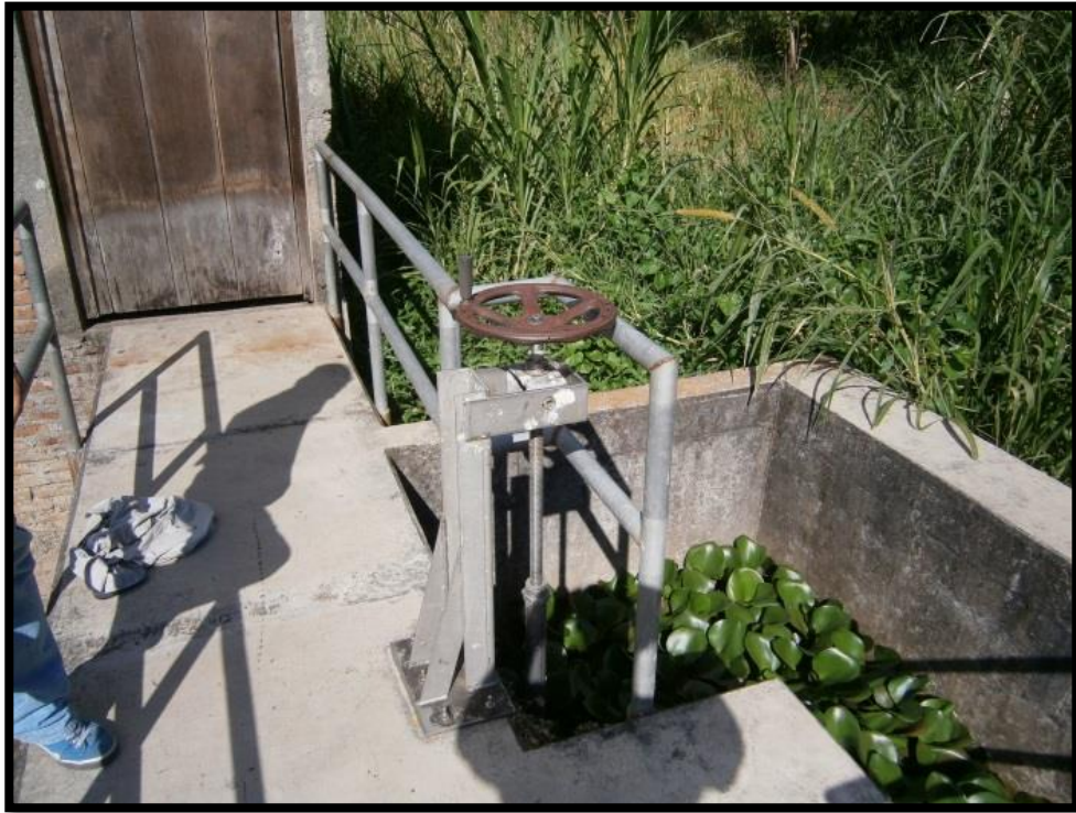
Fotografía Num.3 (Válvula de cierre de compuerta)
