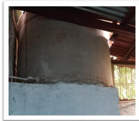
Figura 20: Tanque de Agua
