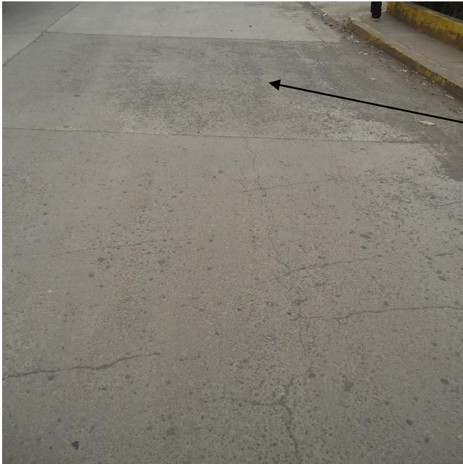
Peladura y deficiencia de sellado
