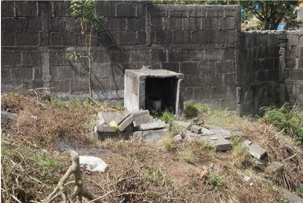
Foto N° A3. Área de basurero con el incinerador
