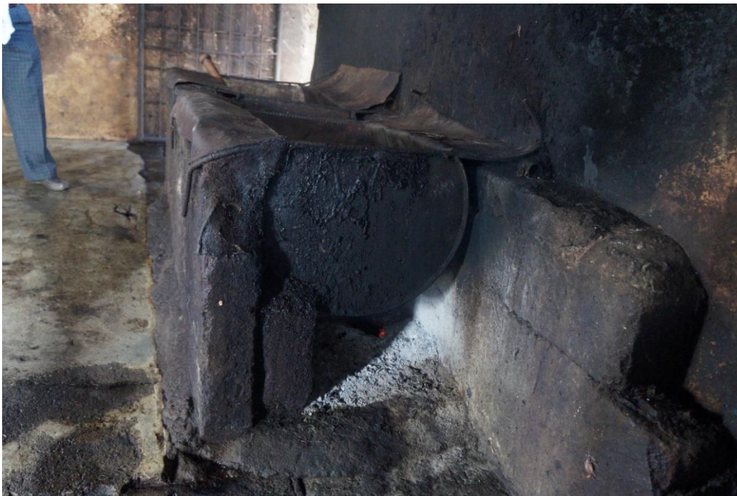
Foto N° A6. Infraestructura en mal estado en área de destace de cerdos
