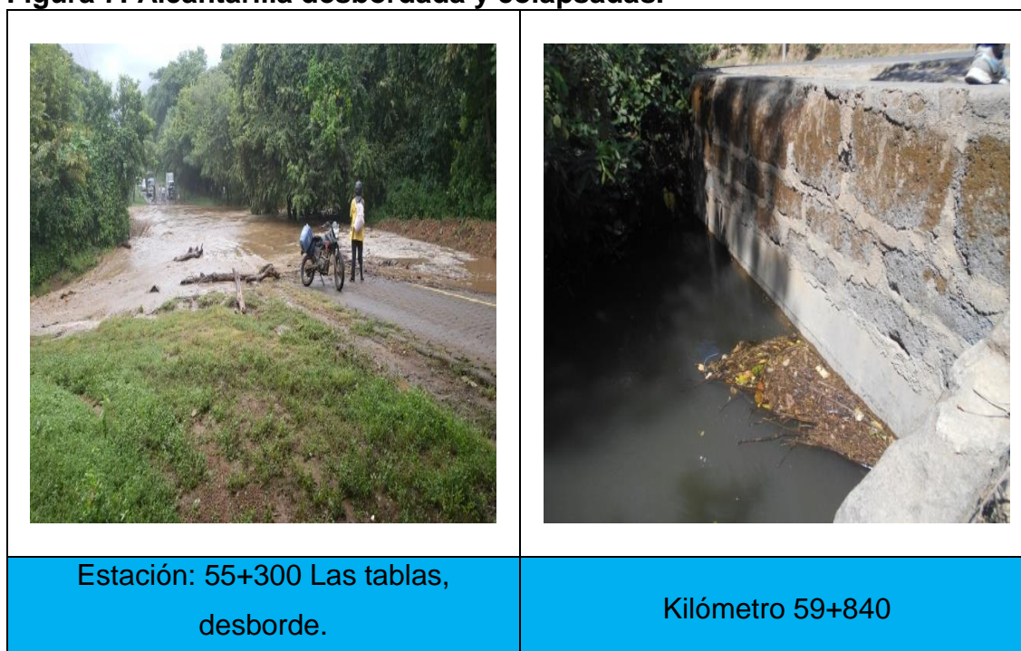
Figura 7: Alcantarilla desbordada y colapsadas.
