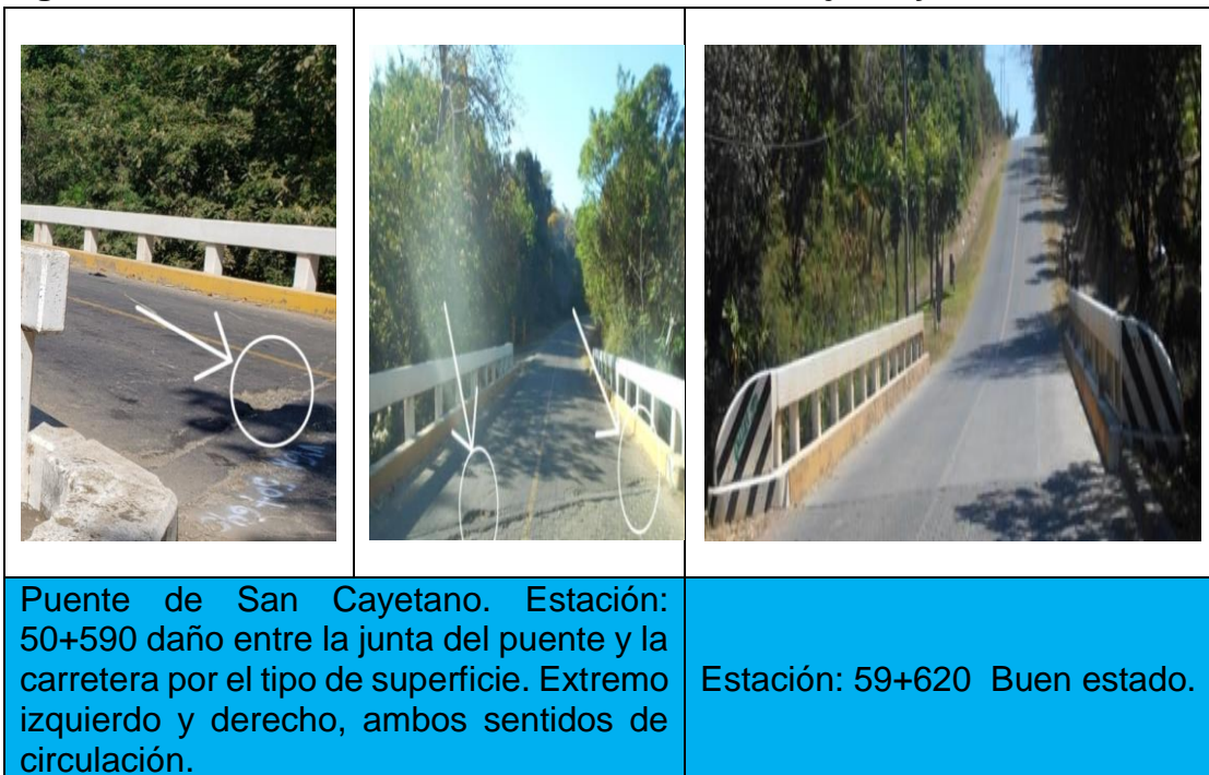
Figura 8: Clasificación del estado físico del drenaje mayor.
