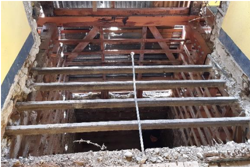
Imagen 97. Rieles de Tren en Losa de Baño.
