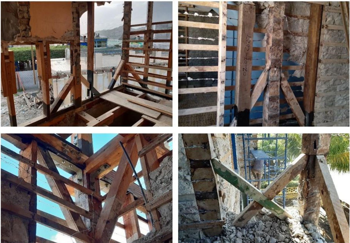
Imagen 95. Arriostres a 45 Grados, Adosados a Columnas y Parales.
