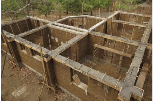
Imagen 24. Viga Corona o Solera de Concreto en Vivienda de Adobe en Managua.
