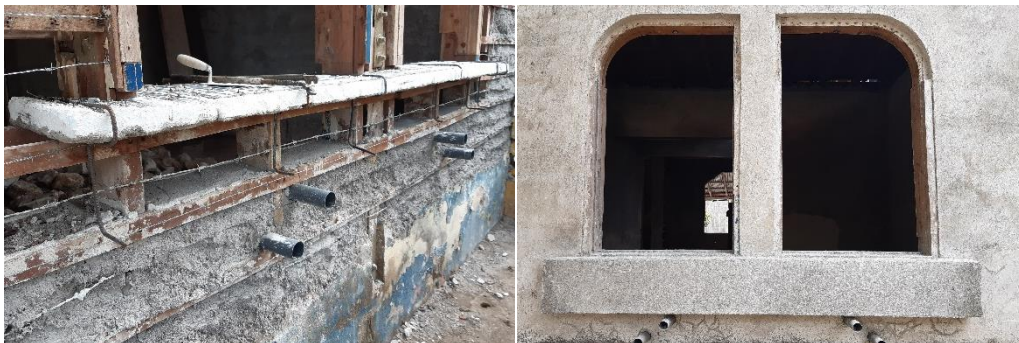
Imagen 116. Reconstrucción de Alfeizar con Láminas de Covintec y Varillas de Hierro de 3/8".
