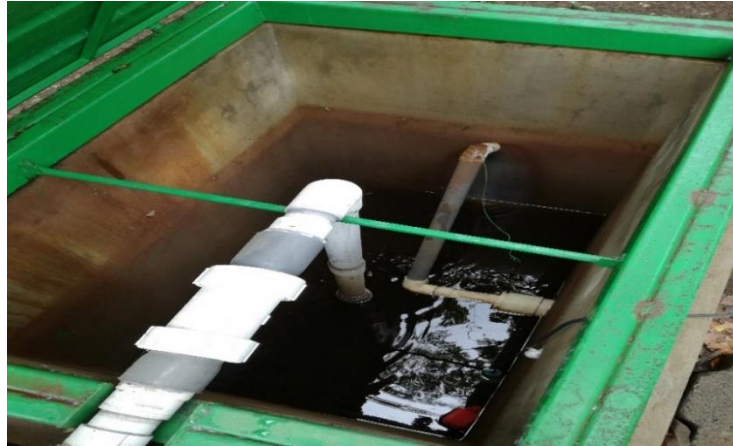
Figura 4.12: Pila de efluente.
