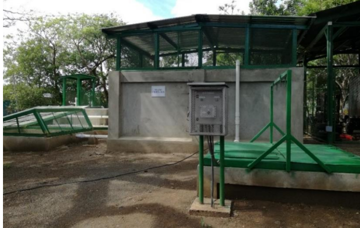
Figura 4.4: Estación de bombeo.
