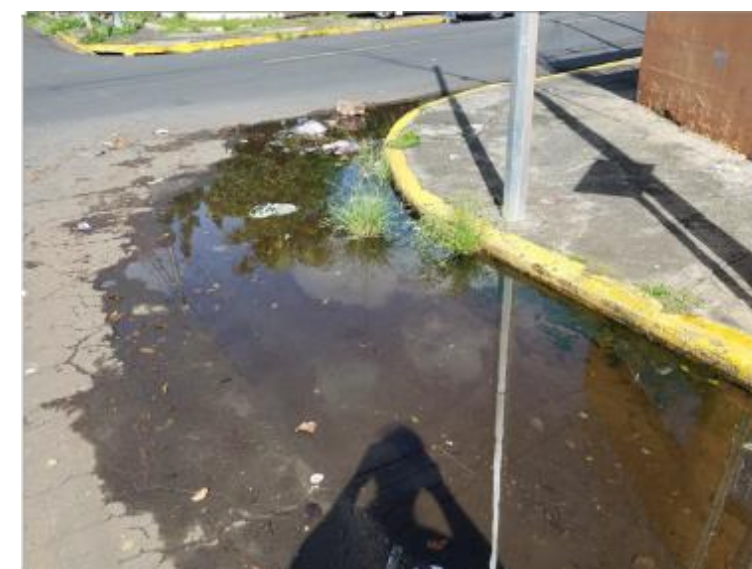
Ilustración 38-Estado actual de las vías del barrio Enrique Smith 2, Fuente: Guillen R.; Gómez, C. y Mercado, M. (2022)
