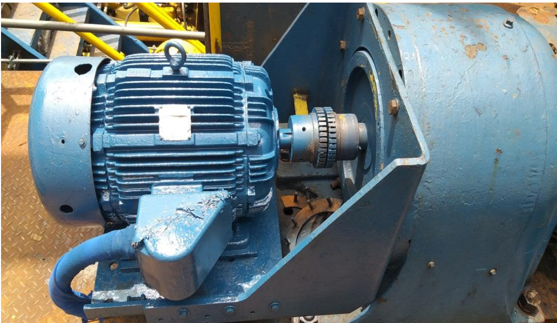
Imagen. Motor eléctrico trifásico, tomada en planta de cogeneración del ISA.
