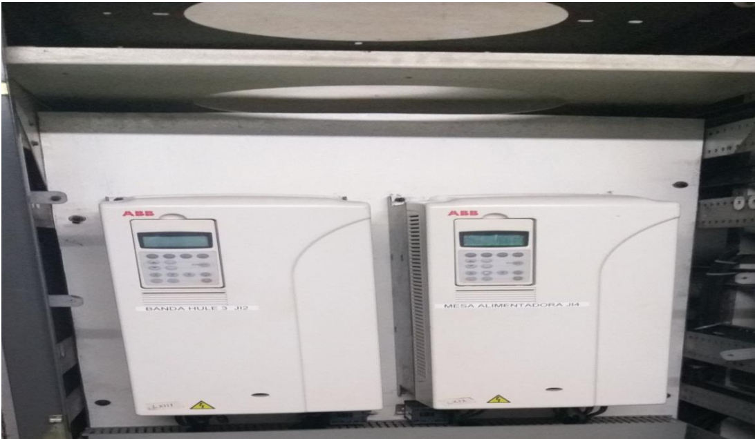
Imagen. Variador de frecuencia para controlar bandas transportadoras.
