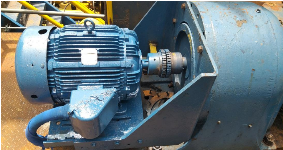
Imagen 4. Motor eléctrico trifásico, tomada en planta de cogeneración del ISA.
