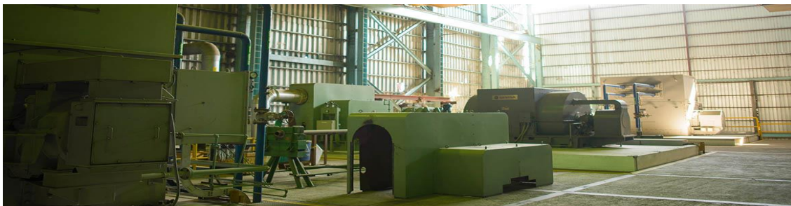
Imagen 8. Turbogenerador, foto obtenida de la planta del ISA.
