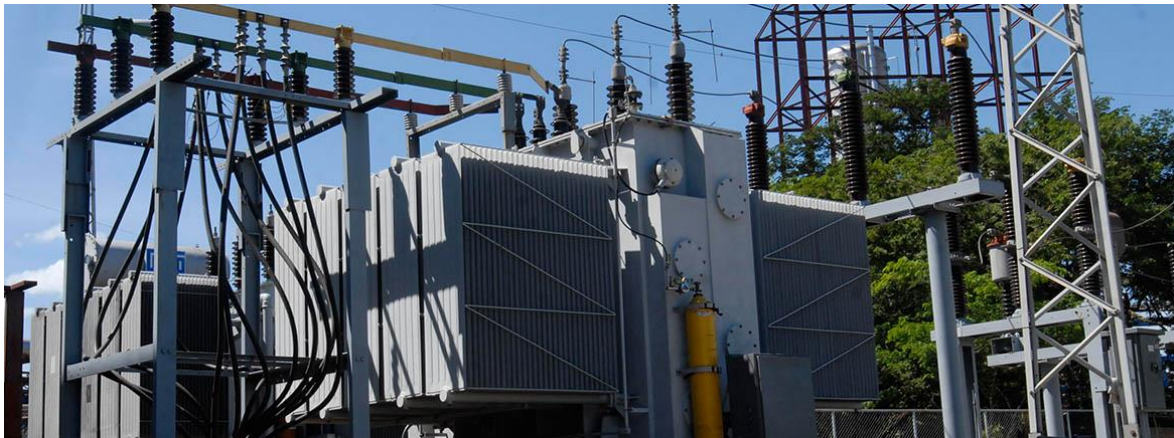
Imagen 9. Transformador de potencia, foto obtenida del ISA.
