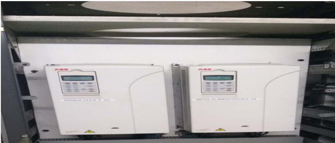
Imagen 7. Variador de frecuencia para controlar bandas transportadoras.
