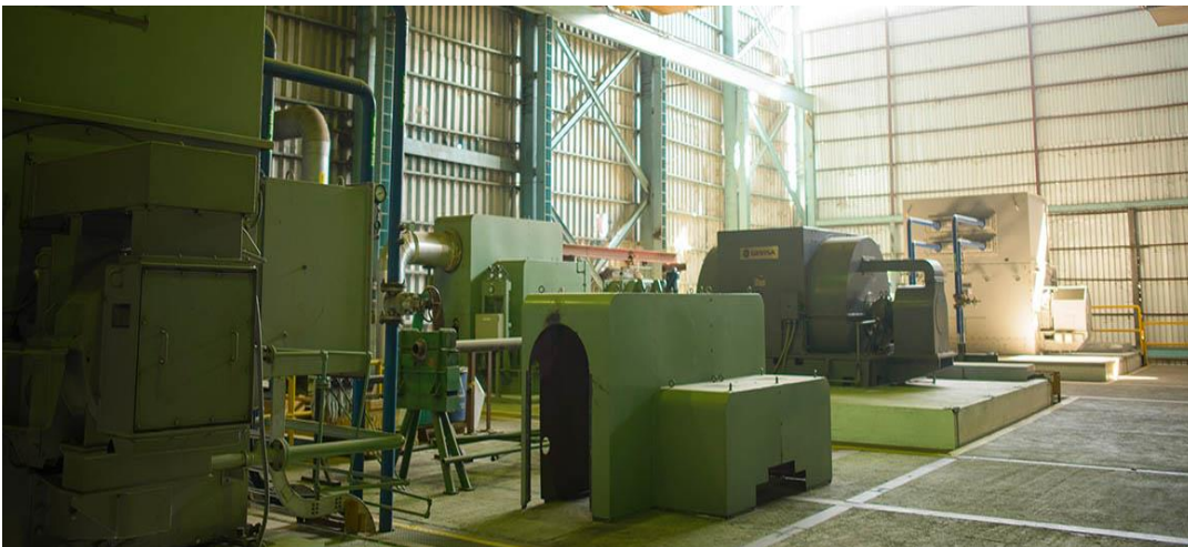
Imagen. Turbogenerador, foto obtenida de la planta del ISA.
