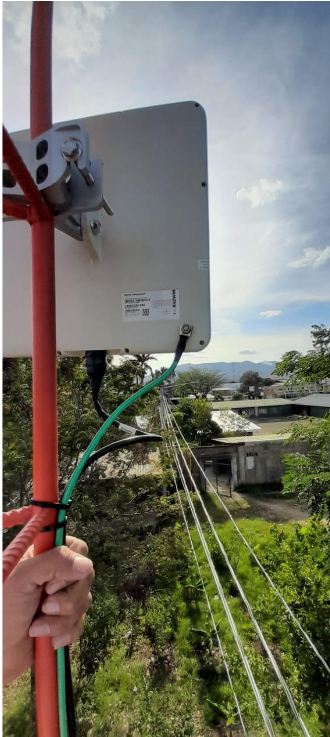
Imagen 3 Instalación Radio Radwin
