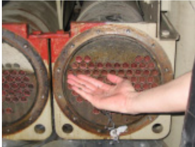
Fig. 5.1 Obtención de incrustaciones de basura y sarro en las tuberías de un condensador enfriado por agua.
