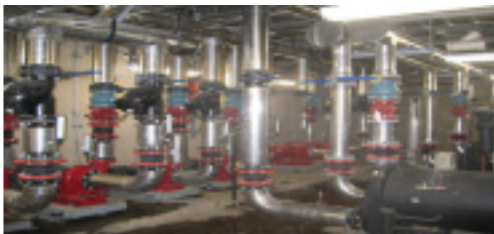
Fig. 2.15 Banco de bombas centrifugas.
