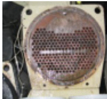
Fig. 2.5 Evaporador del chiller.
