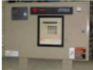
Fig. A-10 Típico panel de control de un Chiller.
