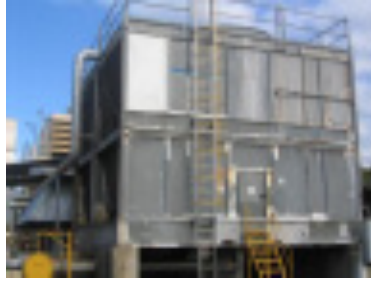
Fig. 2.5 Torre de enfriamiento.
