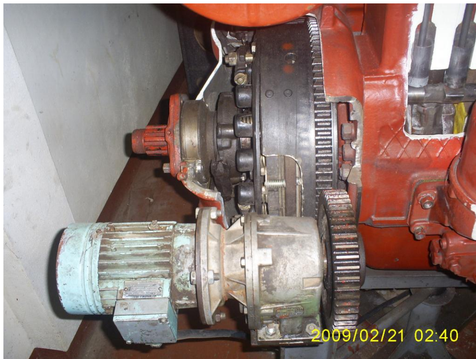
Fig. 22a. Vista lateral de la Instalación motor reductor eléctrico.
