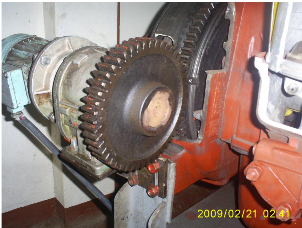
Fig. 22b Vista frontal de la instalación del motor reductor.
