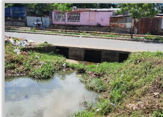
Imagen 5. Drenaje multicelular de sección rectangular (Est 0+900).
