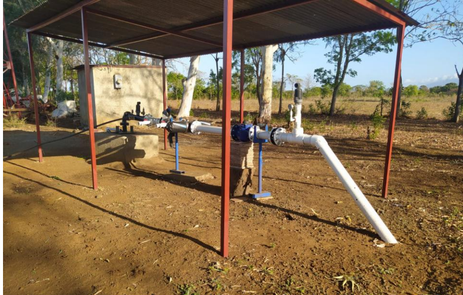
Figura 14. Estación de bombeo
