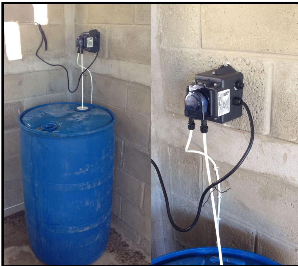
Ilustración 10. Sistema de desinfección para el sistema MABE.
