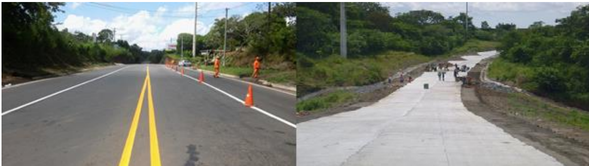
Fig. 1 Imagen de la izquierda, se aprecia Tramo finalizado de pavimento de concreto asfáltico (Estación: km 33+000-32+800, circunvalación Masaya), imagen de la derecha corresponde a pavimento de concreto hidráulico (Estación: km 0+395.40-0+321, circunvalación Masaya). Imagen, Fuente propia.
