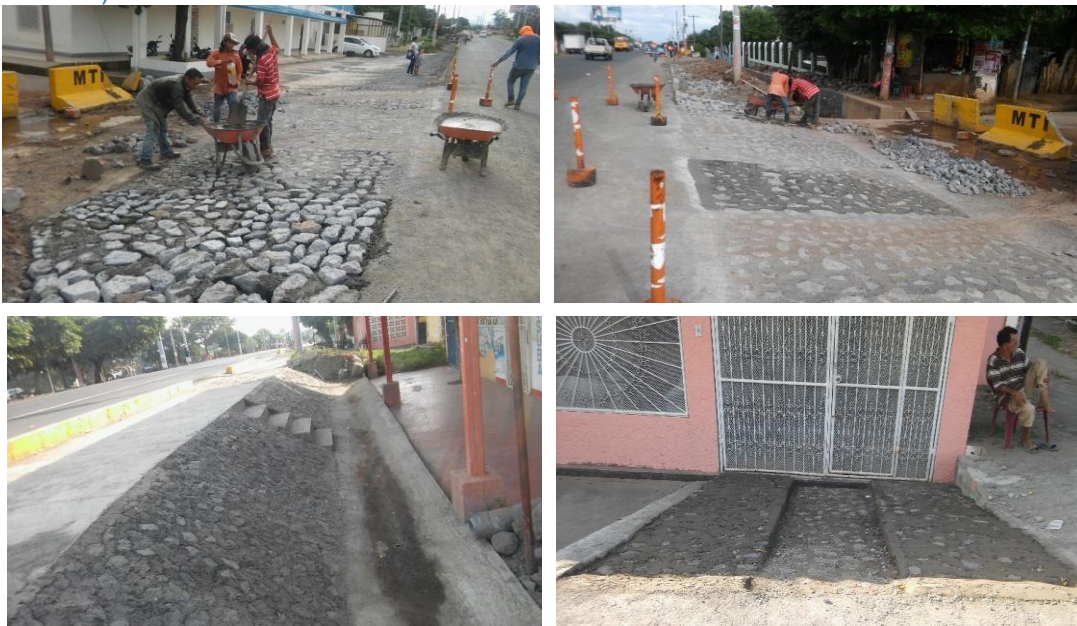
Construcción de zampeado, bajante peatonal y acceso vehicular. Entrada hacia las vivienda
