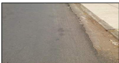
Fotografía II-4.1, EST. 0+526 banda Este Línea lateral ausente
