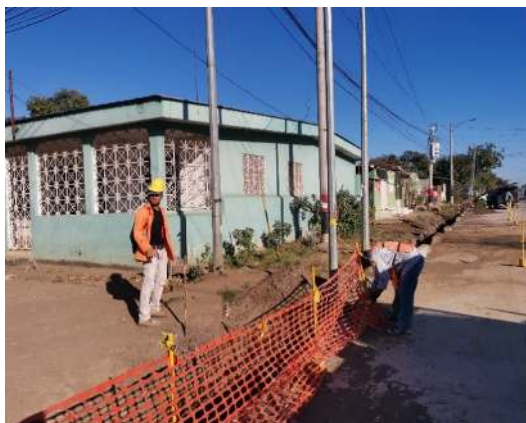
Foto N° 13. Señal prevención de Accidentes
