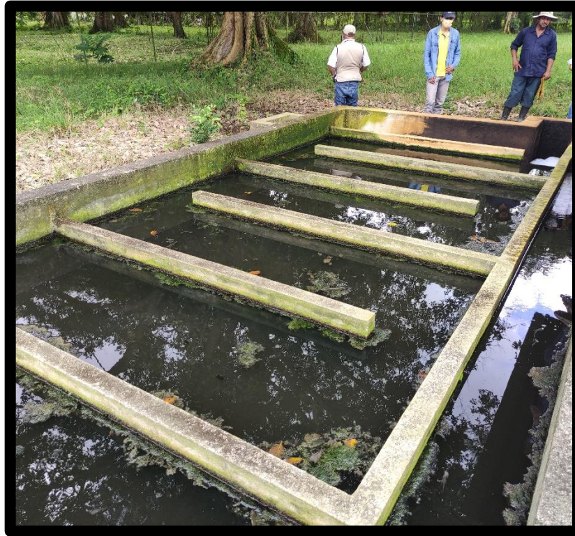
Ilustración 10 Laberinto de cloración
