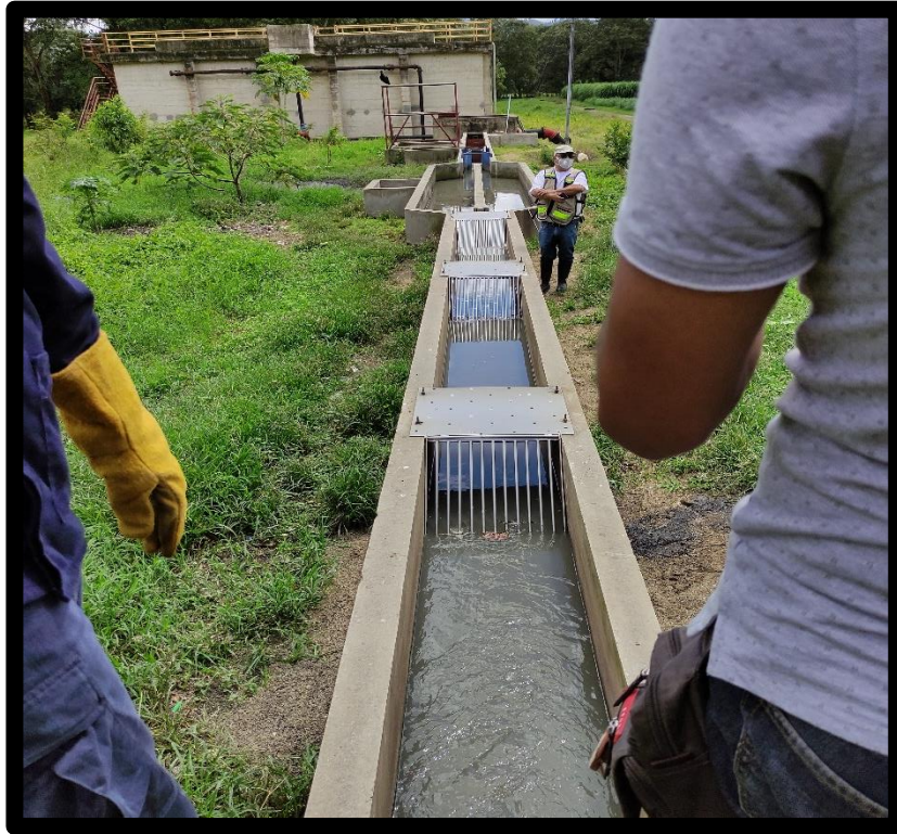
Ilustración 11 Pretratamiento de aguas residuales
