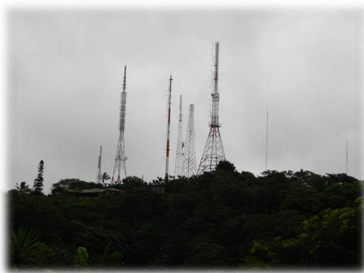
Foto N°10 Antenas de telecomunicación
