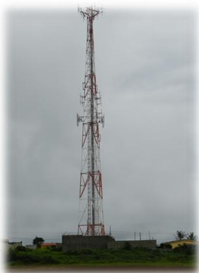
Foto N°9 Antenas de comunicación
