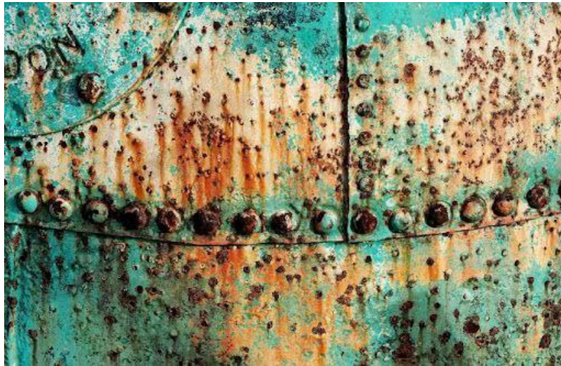
Figura 6: Oxido generado por presión
