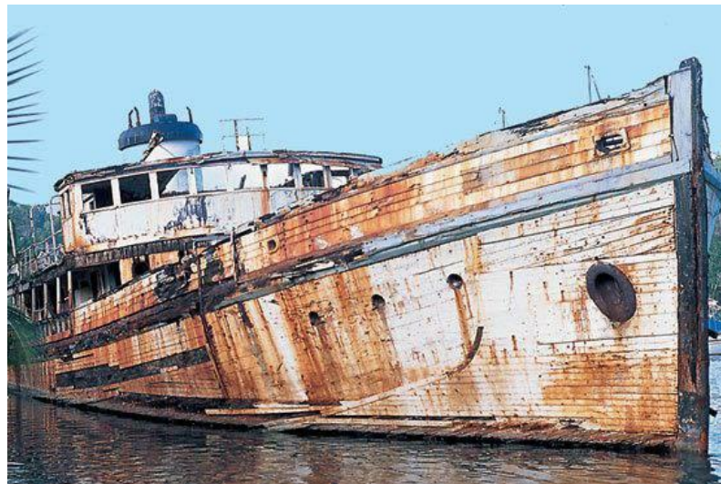
Figura 3: Chapa de barco corroída por ambiente marino
