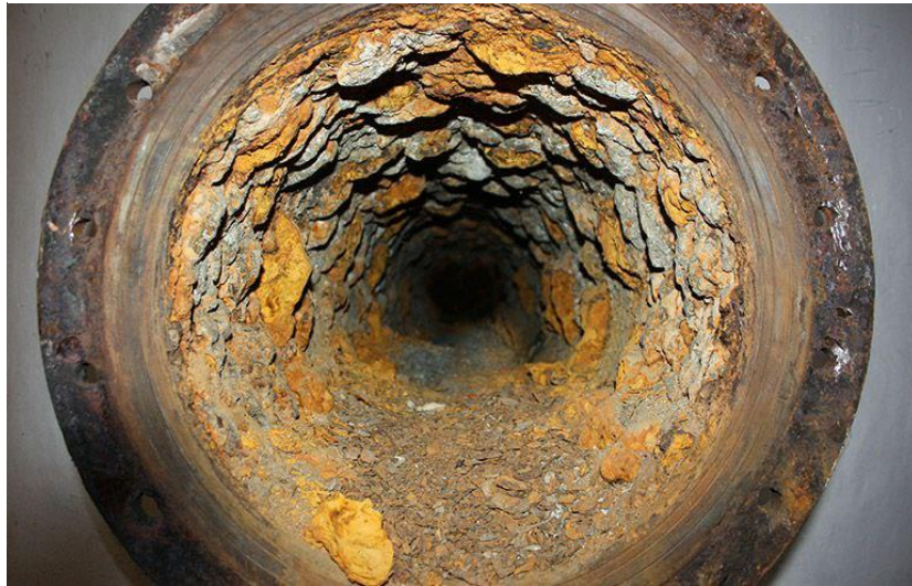
Figura 8: Tubería corroída por MIC
