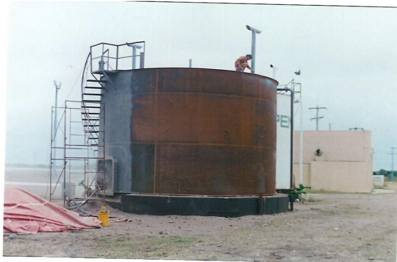
Figura 2: Tanque corroído por ambiente industrial
