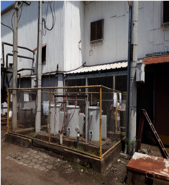
Banco de transformadores de 250 KVA
