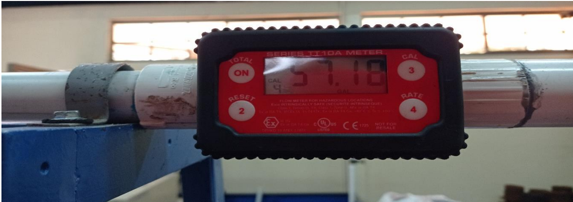
Ilustración VI.22. Medidor de volumen.
