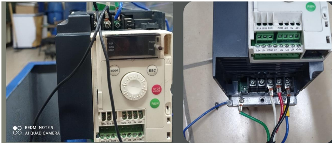
Ilustración VI.19. Borneras del variador de frecuencia.
