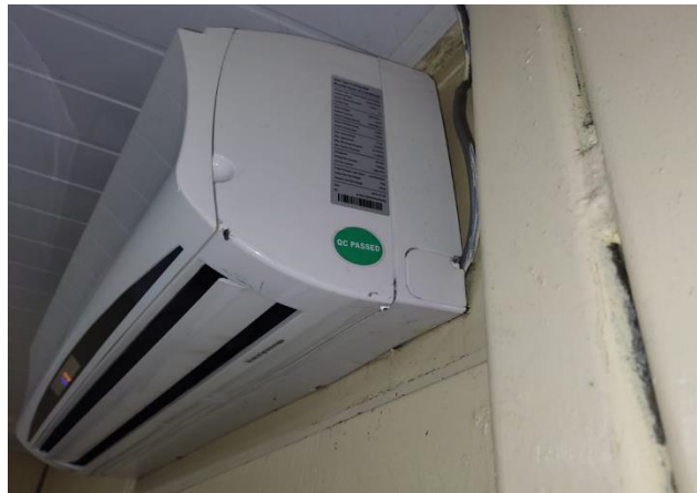
Ilustración 21. Aire acondicionado de pared localizado en el recinto universitario. Fuente: Elaboración propia.
