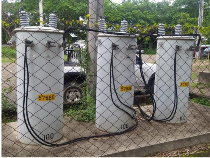
Anexo 5. Centro de transformación #06, 3x100 kVA
