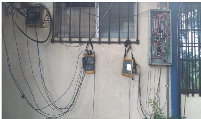
Anexo 9. Panel eléctrico principal CNEG
