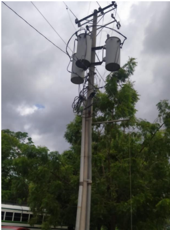
Anexo 4. Centro de transformación #05, 3x75 kVA
