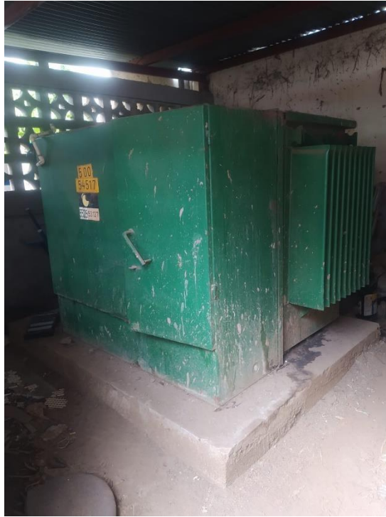
Anexo 3. Centro de transformación #03, 500 kVA
