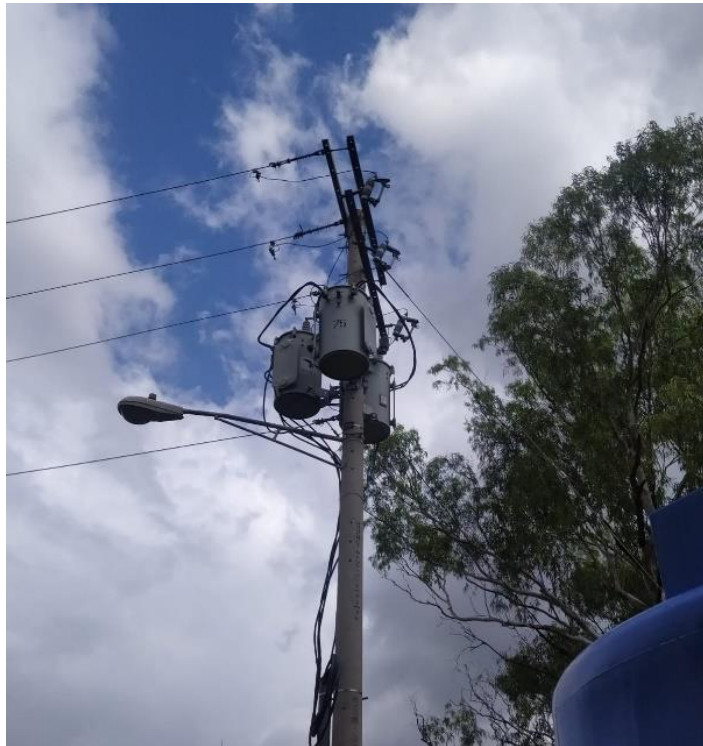
Anexo 6. Centro de transformación #08, 3x75 kVA
