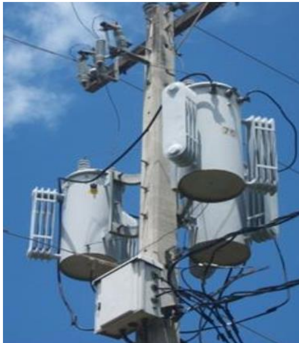
Anexo 1. Centro de transformación #01, 50 kVA y 75 kVA
