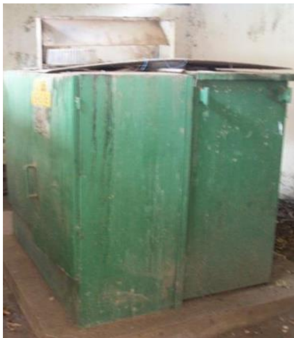
Anexo 2. Centro de transformación #02, 225 kVA
