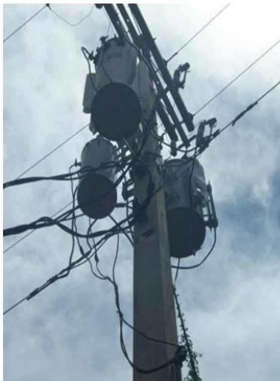
Anexo 7. Centro de transformación #09, 3x75 kVA
