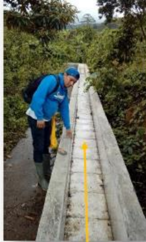
Foto No 6. Canal de Correteo Finca la Quinta. (Fuente Propia)
