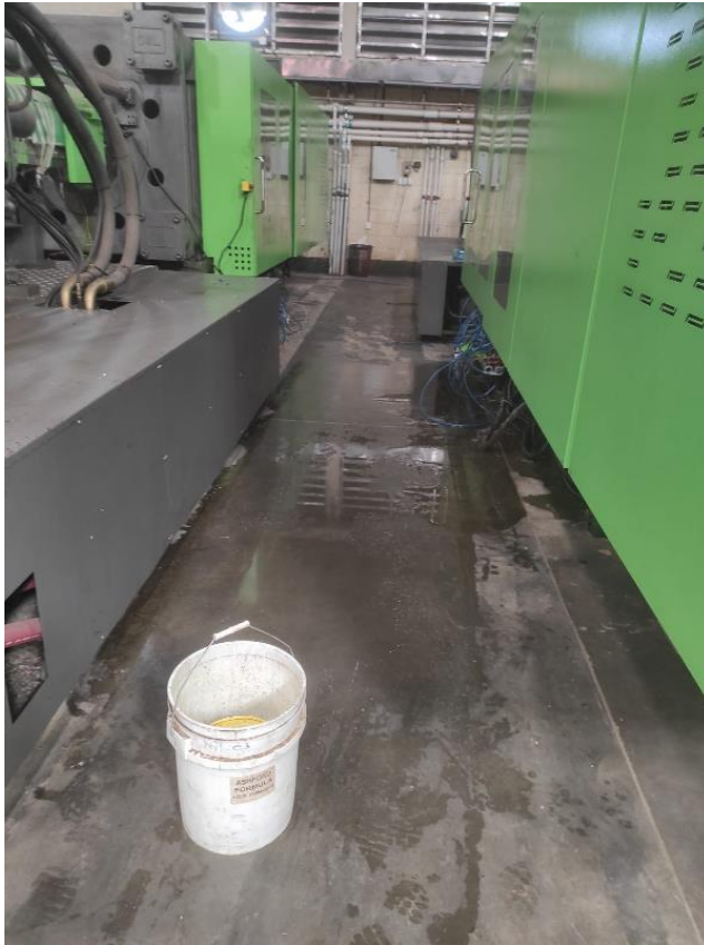
Ilustración 19 Peligro de caída al mismo nivel por piso mojado
