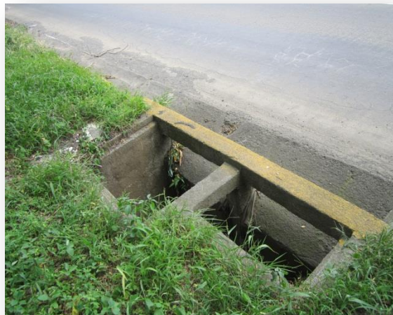
Foto No.19: Tragante pluvial sin tapa sobre la pista suburbana
