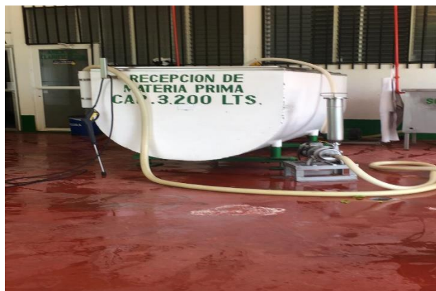
Figura 7. Tina de recepción y filtro
