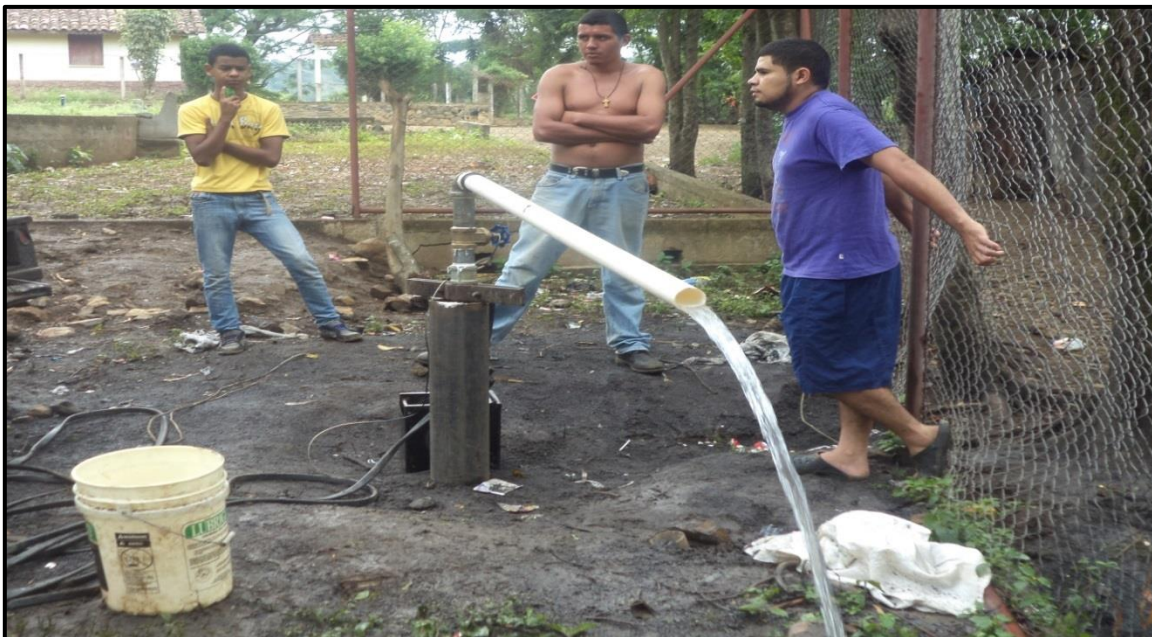
Imagen N°: 14, Aforo, caudal de pozo.
