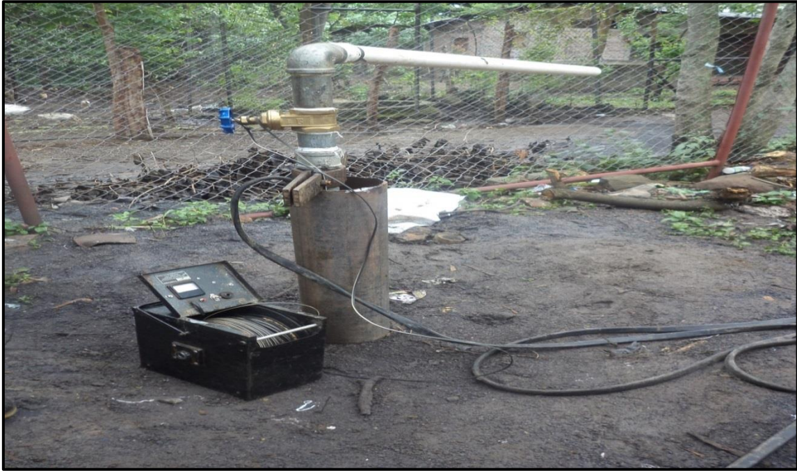
Imagen N°: 13, Aforo, caudal de pozo.
