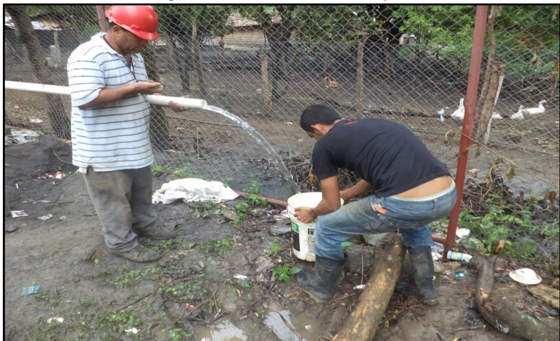
Imagen N°: 12, Aforo, caudal de pozo.
