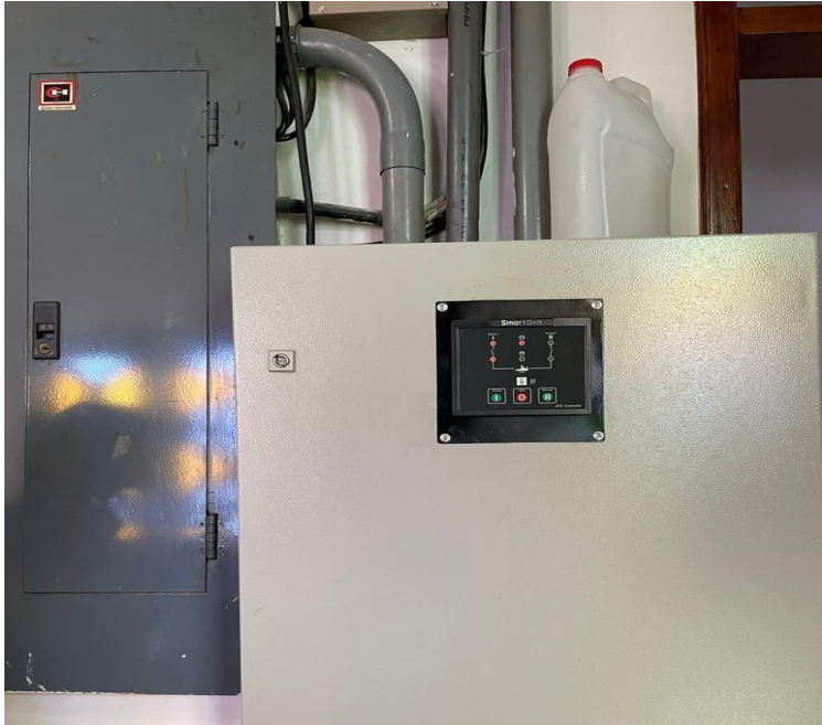
Anexo 5. Generador eléctrico
