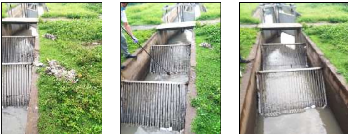
Imagen 5. Canal de rejas de limpieza manual
